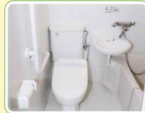
浴室・水洗トイレ・洗面設備
