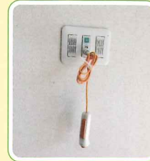
緊急通報設備
